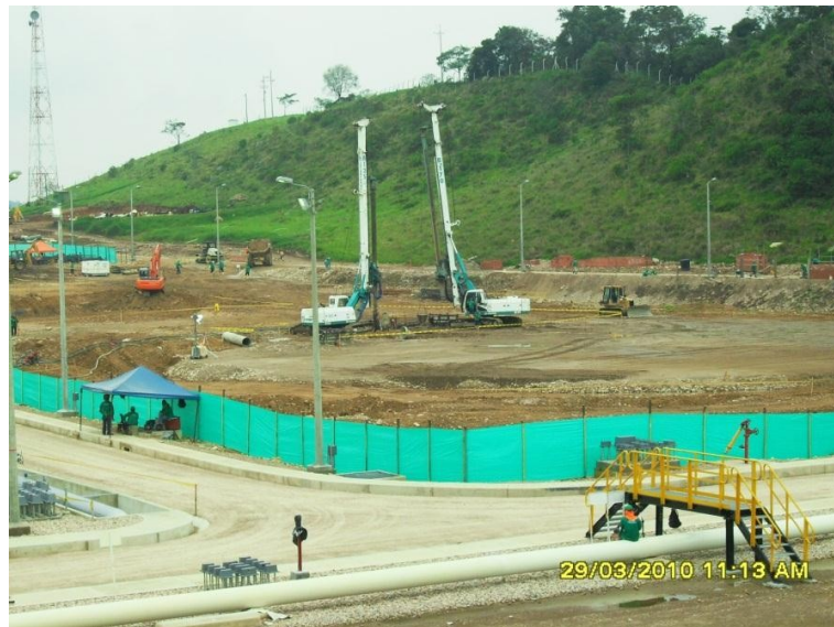
Tanque TK 5104 170.000 barriles Ecopetrol Altos del Porvenir Casanare Colombia
